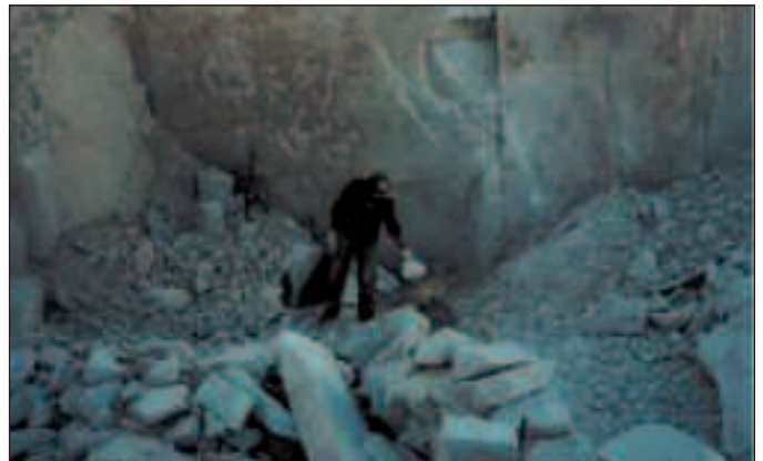
Fig. 6. Explotación de toba Toconao, II Región Fig. 6. Toconao tuff working, II Region
